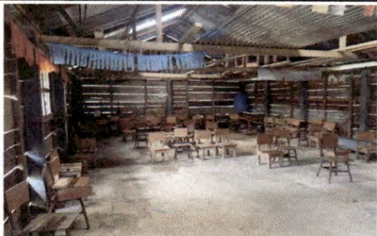
Foto 3: Piso con grietas.
