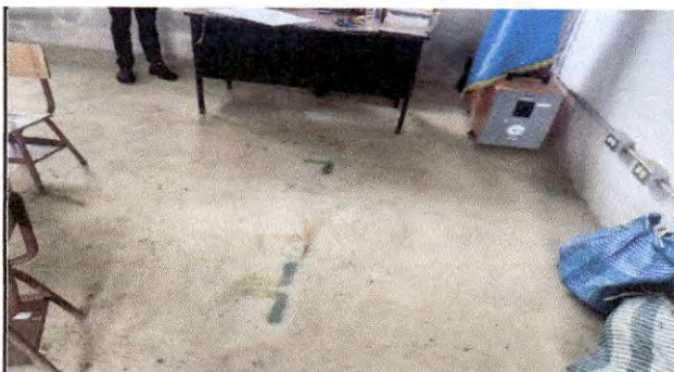
Foto 5: piso en malas condiciones.
