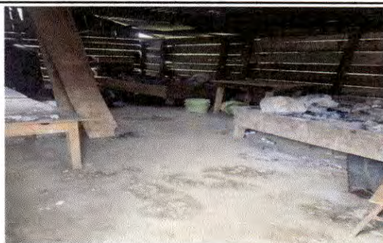
Foto 8: Piso en pésimas condiciones en cocina.
