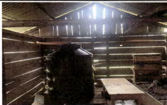
Foto 9: Tinaco de agua sin conexión.
